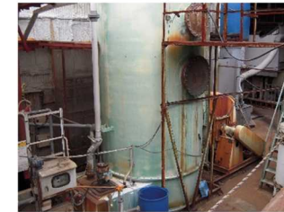
ブロワーで誘引し、発生ガスを中和消臭
