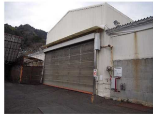
開閉時タイマーによる消臭剤噴霧
