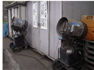
場内消臭噴霧器
